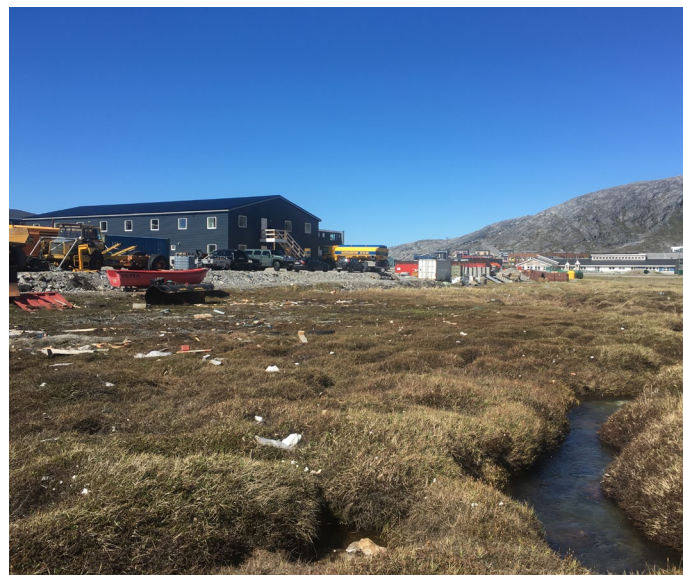
Fig. 3 Affald/byggematerialer på tilstødende naturområde. Skellet mellem byggeplads og naturområde udviskes og der opstår miljøforurening. I sådanne tilfælde kan der kræves indhegning af arealet hvorfra materialerne kommer.
