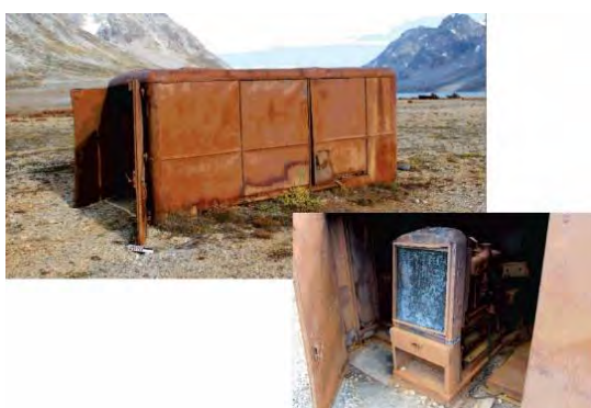
Fig. 16. En LeRoi-motor, gasdrevet generator placeret ved siden af hangaren inde i et beskyttende stålkabinet ved Ikkatteq-BE2 (fotos: H. Lange 2018).
